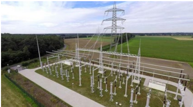
Abb. 2-22: Beispiel einer Kabelübergabestation, Quelle: Amprion GmbH
