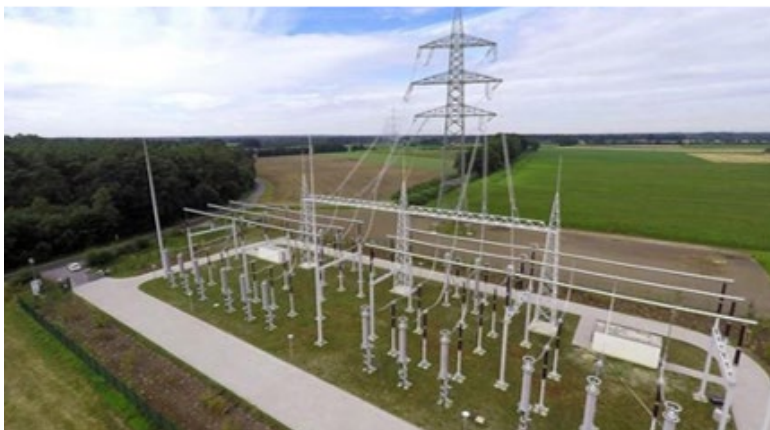
Abb. 2-25: Beispiel einer Kabelübergabestation, Quelle: Amprion GmbH
