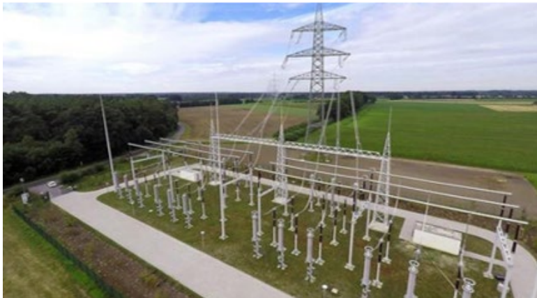
Abb. 2-22: Beispiel einer Kabelübergabestation, Quelle: Amprion GmbH
